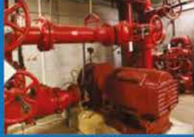
Yangın tesisatları sistemleri
