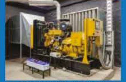
Dizel jeneratör uygulaması
