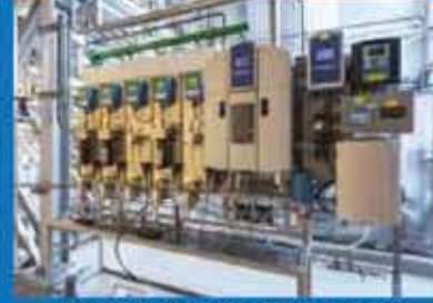
Alçak gerilim bina uygulaması
