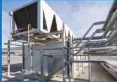
Soğutma sistem uygulaması
