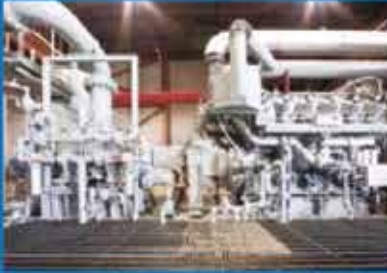
Doğal gaz tesisatı sistemleri
