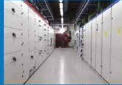
Elektrik panosu uygulamaları
