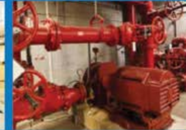
Yangın tesisatları sistemleri
