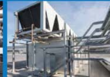
Soğutma sistem uygulaması
