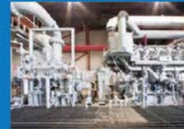
Doğal gaz tesisatı sistemleri
