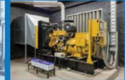
Dizel jeneratör uygulaması
